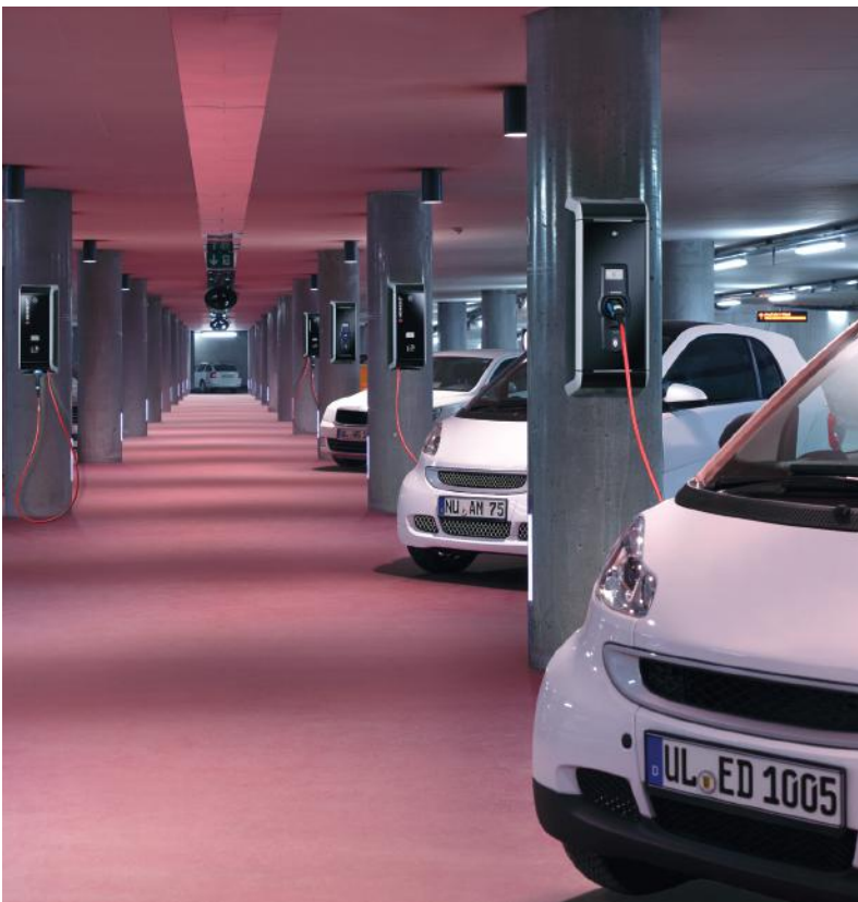
Bild 9: Ladeeinrichtungen für Elektrofahrzeuge in einer Tiefgarage
