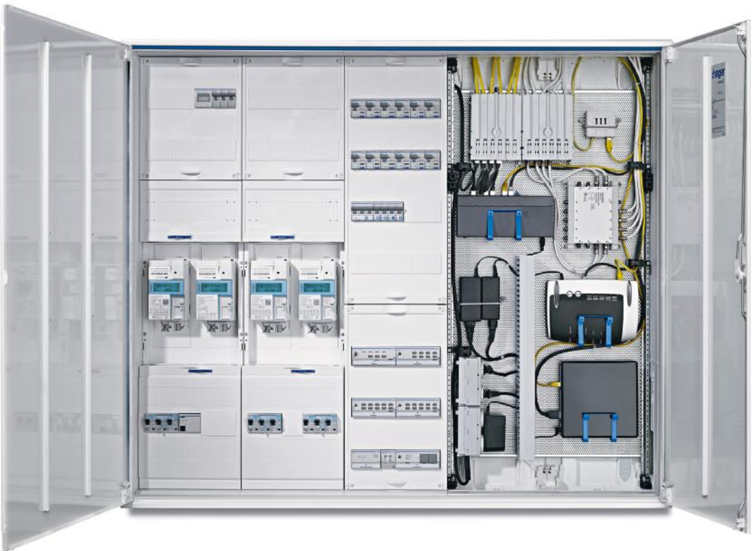
Bild 8: Moderner Zähler-schrank mit elektronischen Haushaltszählern, u. a. für PV-Anlage, Wärmepumpe oder Elektrofahrzeug
