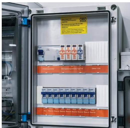
Bild 11: Im Verteiler eingebaute Überspannungsschutzeinrichtung Typ 2
