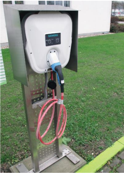
Bild 12: Ladestation im Außenbereich mit Regendach
